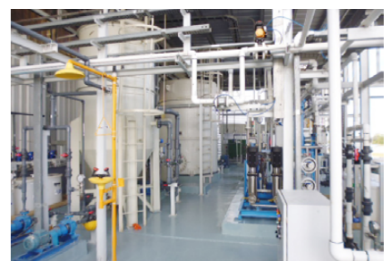
工程廃水を100%再利用
