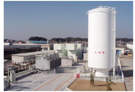
掛川工場のコジェネレーション設備
