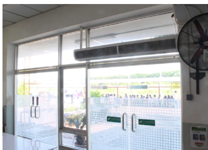
虫の侵入を防ぐエアカーテンの設置
