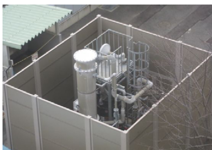
本社事業所の地下水浄化装置
