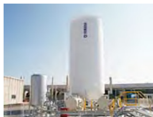
LNGサテライト施設
