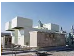
コージェネレーションシステム設備
