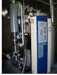
YMPI・天然ガスボイラー
