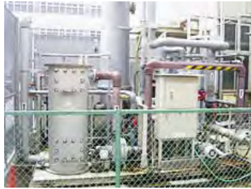
本社工場の地下水浄化装置
