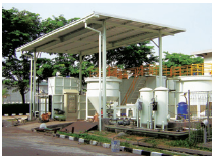
更新した排水処理設備
