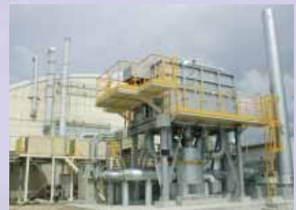
排ガス処理装置
