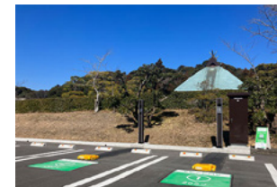
再生可能エネルギーによるEV車充電スタンド
