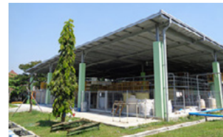
廃水処理施設(ヤマハ・ミュージカル・プロダクツ・インドネシア)
