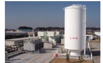
掛川工場のコージェネレーション設備
