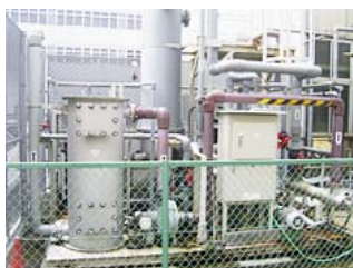
本社工場の地下水浄化装置
