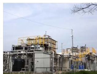
廃水処理施設（掛川工場）
