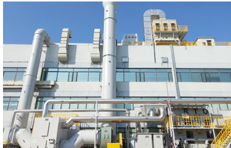
杭州ヤマハのVOC処理施設
