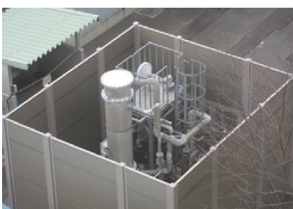
本社事業所の地下水浄化装置
