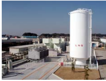
LNG Satellite Facility
