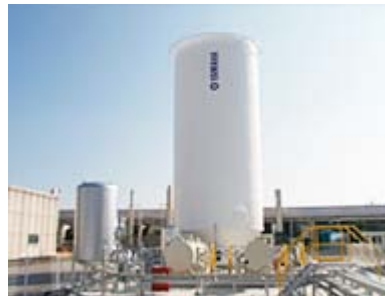
LNG satellite facility
