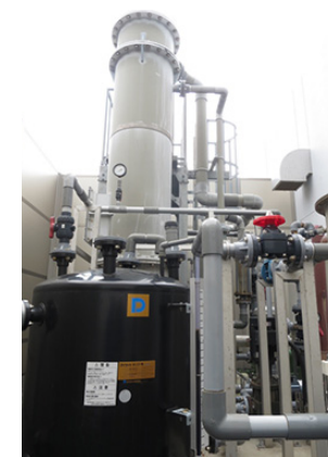
本社事業所の地下水浄化装置
