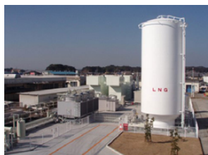
掛川工場のコージェネレーション設備
