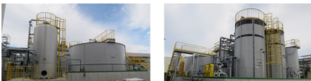
(株)ヤマハミュージックマニュファクチャリング本社工場の廃水処理設備
