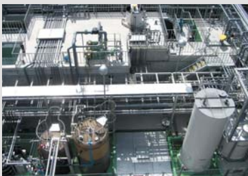
排水処理設備(ヤマハ鹿児島セミコンダクタ)
