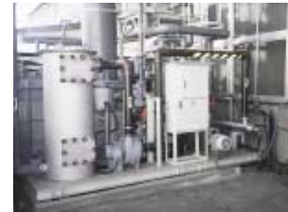
浄化設備(本社)
