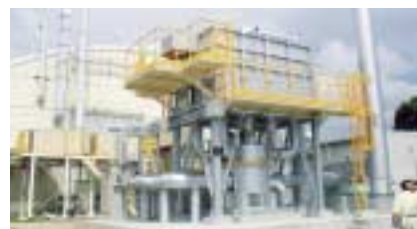
蓄熱式排ガス熱処理装置 (天竜工場)
