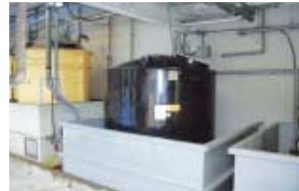
排水処理設備の防液堤(埼玉工場)
