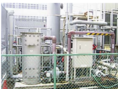
本社事業所の地下水浄化装置
