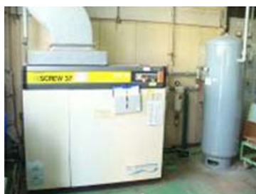
圧力の適正化を行ったコンプレッサー
