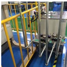
循環水で供給可能な冷却装置（蕭山ヤマハ楽器）
