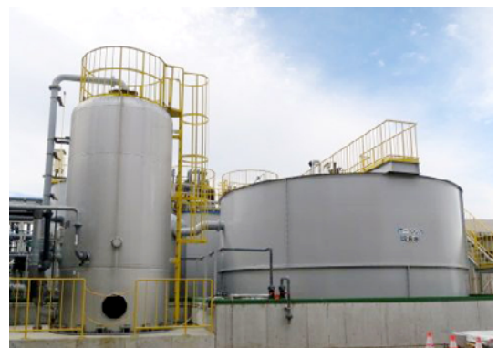
(株)ヤマハミュージックマニュファクチャリング本社工場の廃水処理設備
