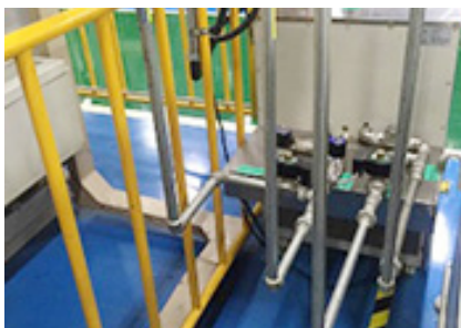
循環水で供給可能な冷却装置(蕭山ヤマハ楽器)
