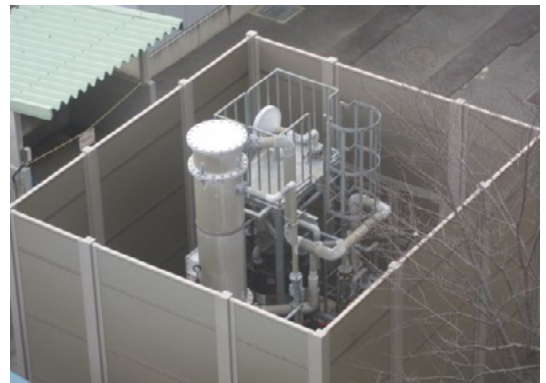
本社事業所の地下水浄化装置
