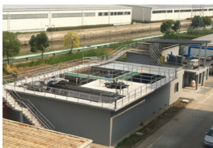
廃水処理施設(杭州ヤマハ)
