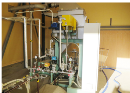
CD dryer (Kitami Mokuzai Co., Ltd.)
