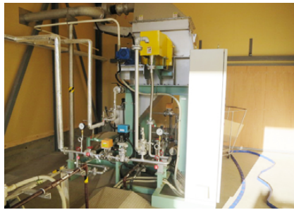
CD dryer (Kitami Mokuzai)
