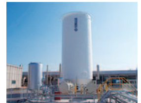
LNG satellite facility
